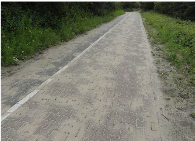
Figuur 3 Enorme dichtheid aan plaagmiernestopeningen onder bestrating (foto Martijn Kos)
